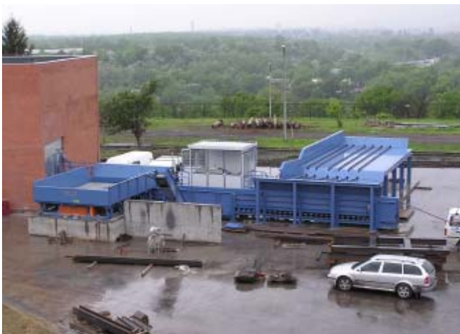
Участок подготовки и подачи древесного сырья на электростанции в Венгрии (30 МВт в час).
