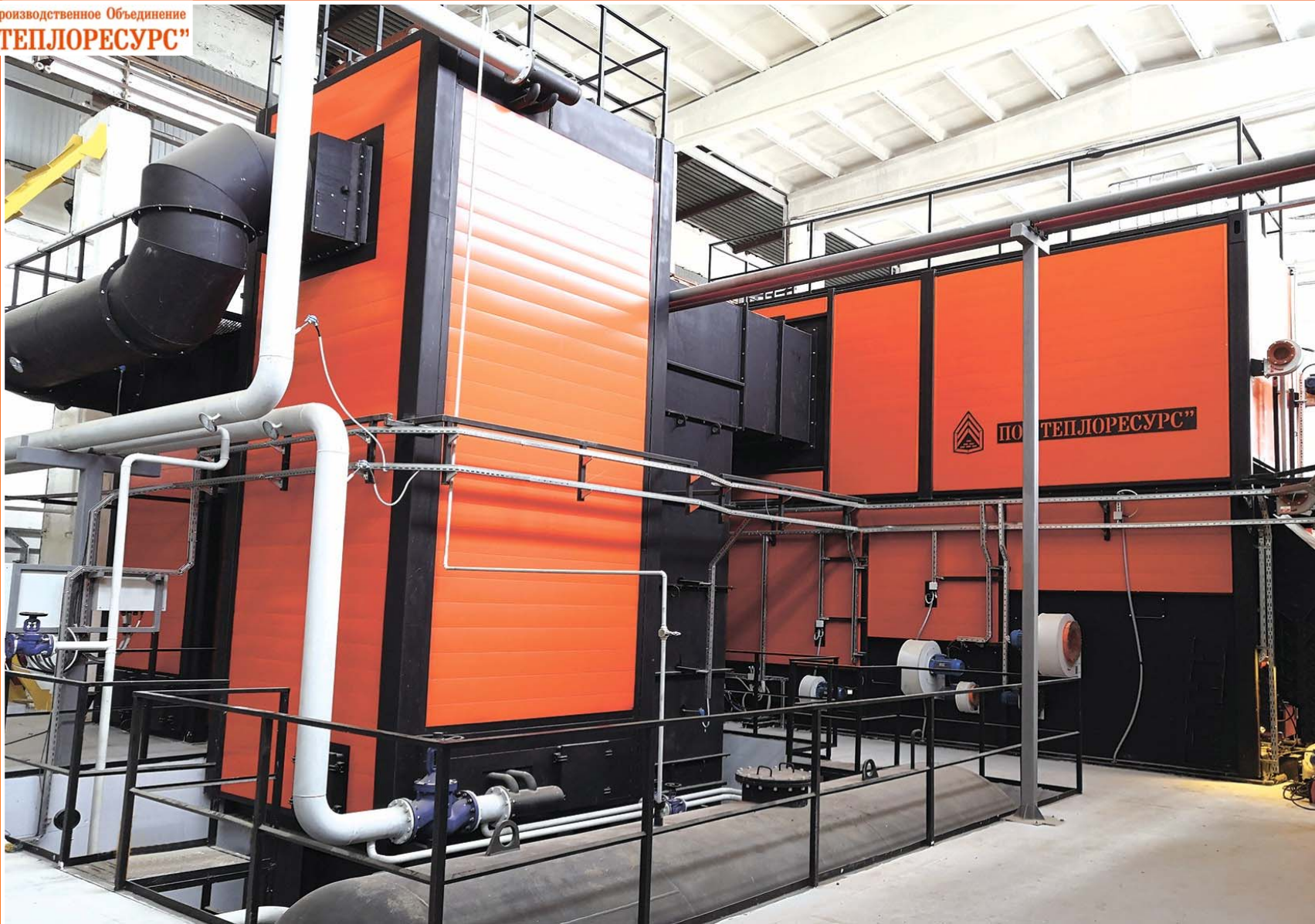
Термомасляная котельная 11 МВт
