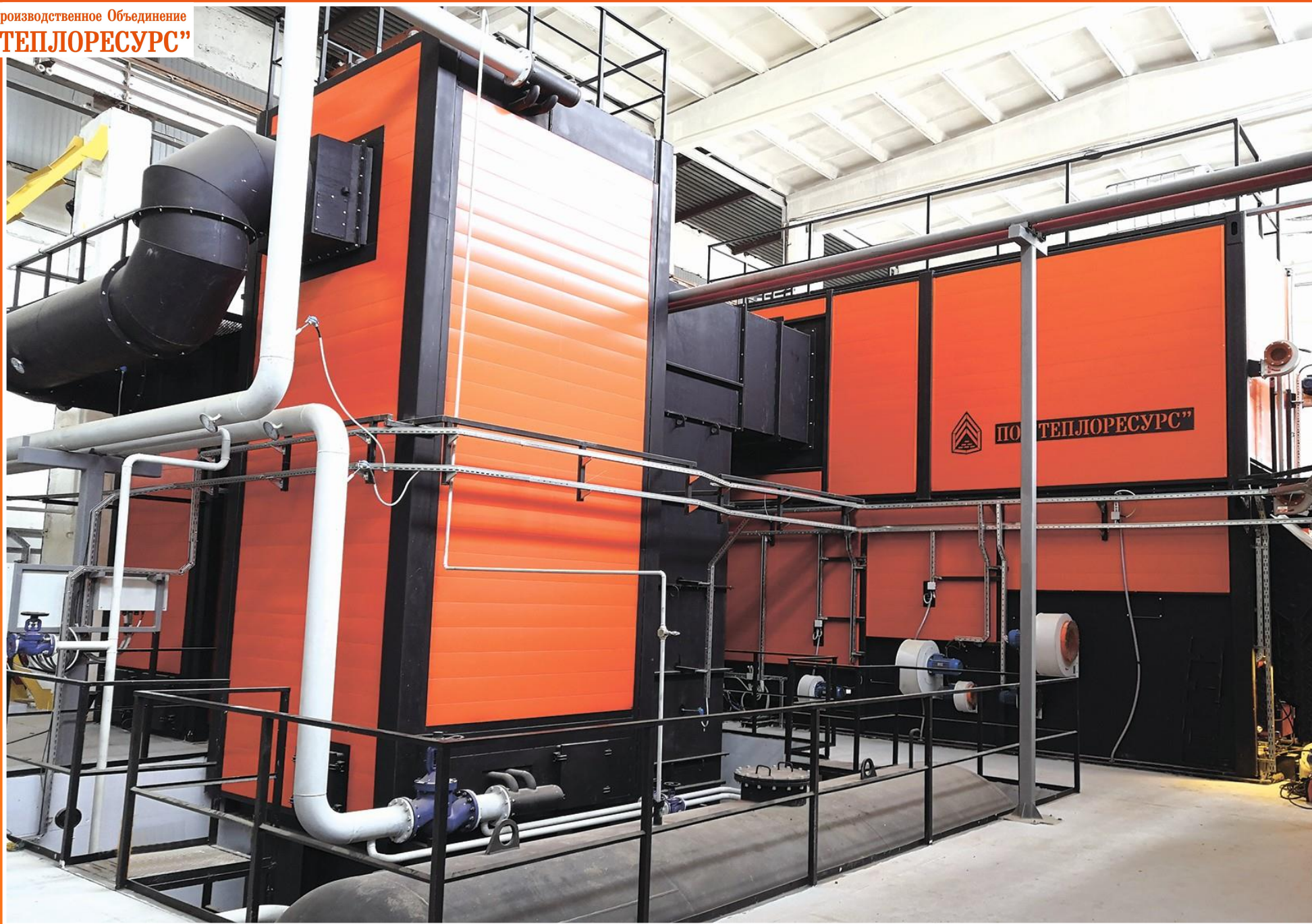
Термомасляная котельная 11 МВт Вологда Вологодский Лес
