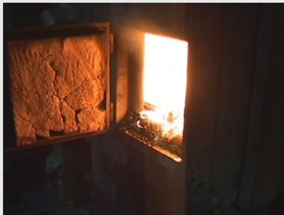
Горение брикетов в топке котла
